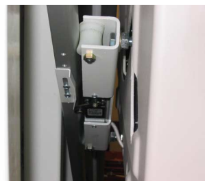
Fig. 6.4a Rampe de contacteur d'approche de palier
